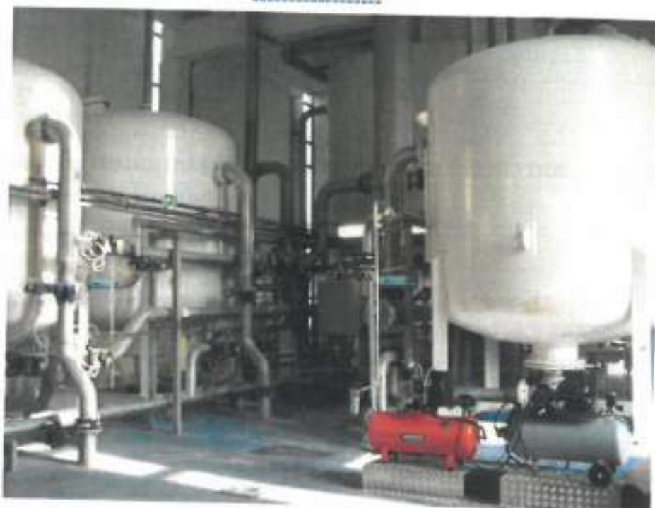
La station de traitement
